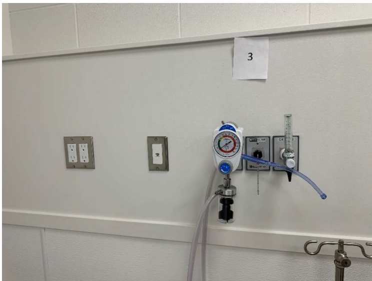
Photo 2: existing Med Gas layout
